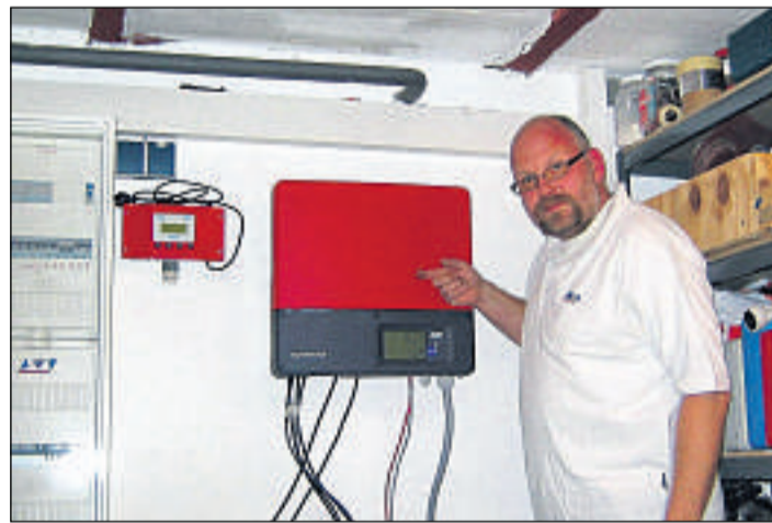
Michael Wiese aktiviert das Display seines SMA-Wechselrichters: Die Anlage erzeugt mindestens 4400 kWh Solarstrom pro Jahr und vermeidet so rund vier Tonnen CO 2 .
